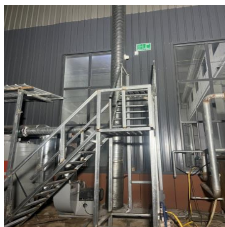
图 3-1 现场废气处理设施
