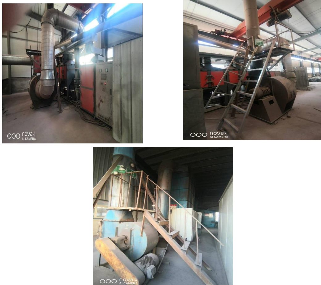
图 3-1 现场废气处理设施
