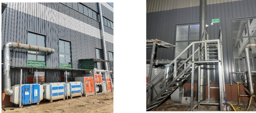
图 3-1 现场废气处理设施
