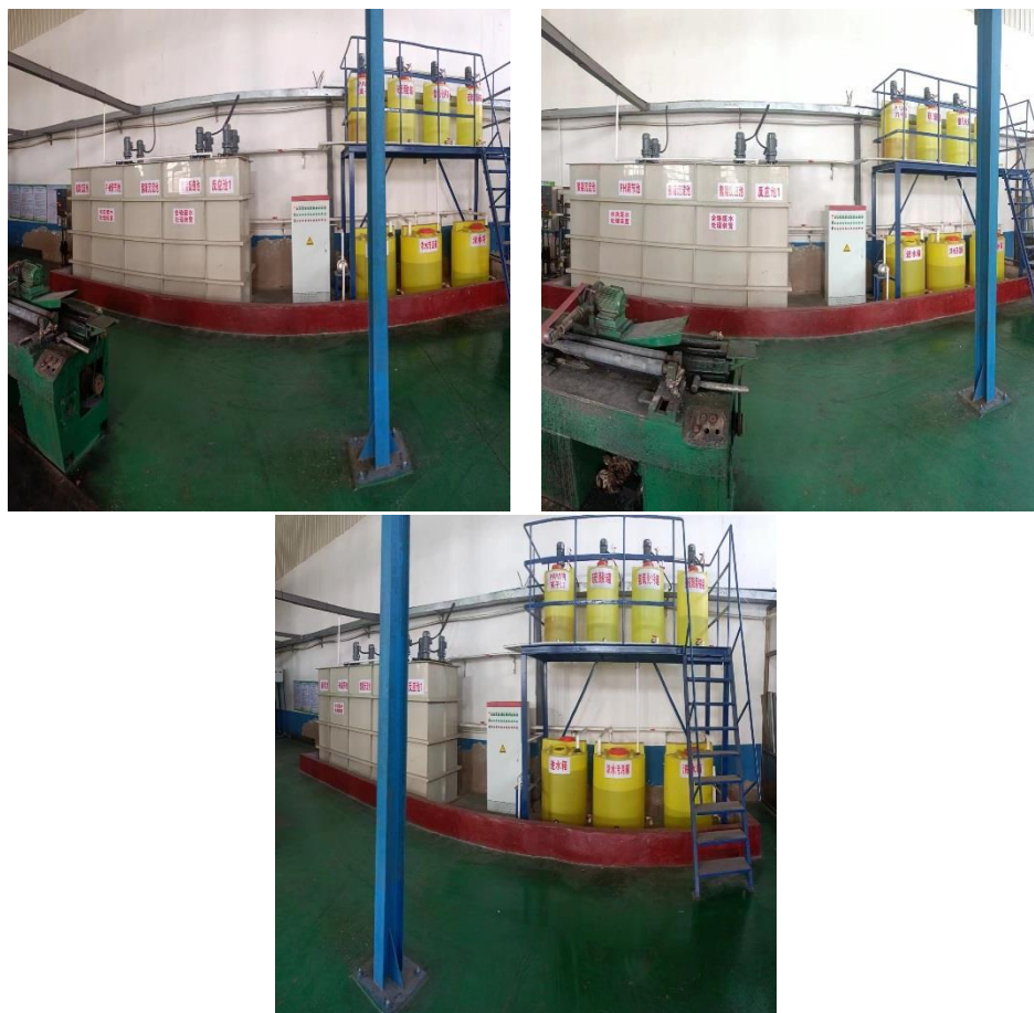
图 4.1-4 废水处理设施现状图
