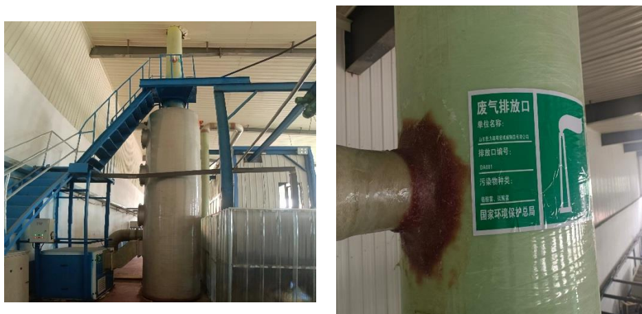
图 4.1-5 废气处理设施
