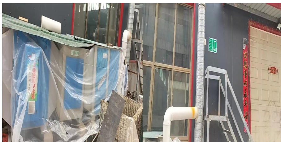
图 3-1 现场废气处理设施
