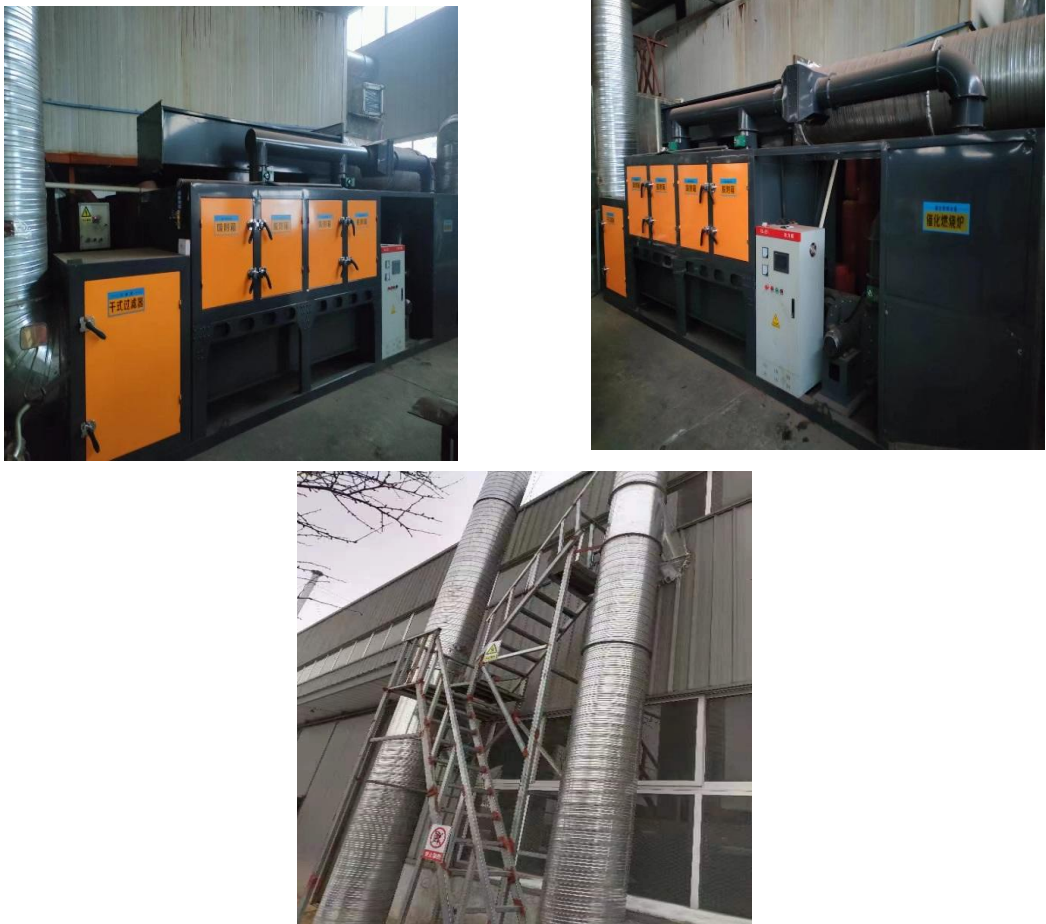
图 3-1 现场废气处理设施
