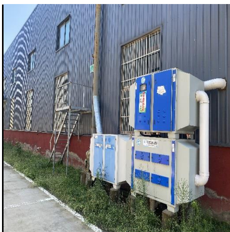
图 3-1 现场废气处理设施
