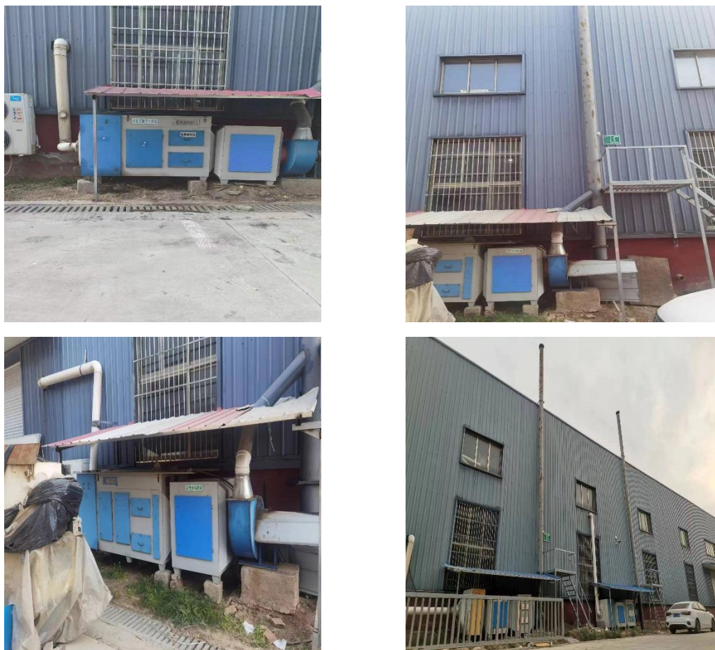
图 3-1 现场废气处理设施
