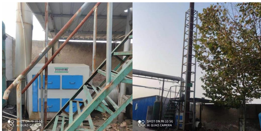
图 3-1 现场废气处理设施
